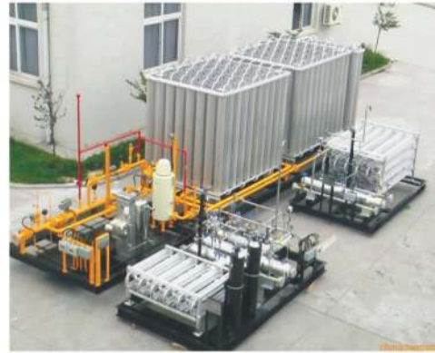
● LNG气化站撬
